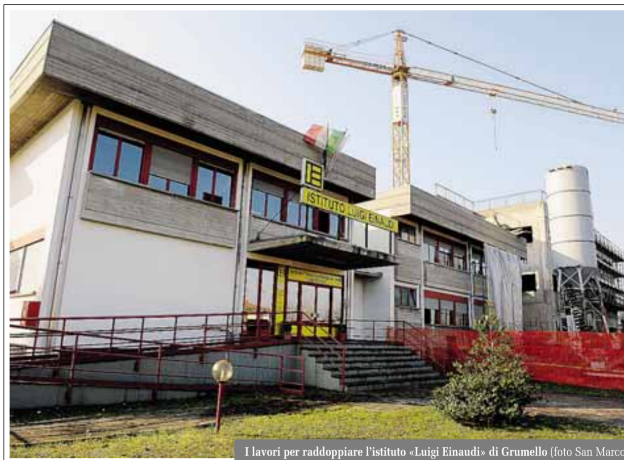
I lavori per raddoppiare l'istituto «Luigi Einaudi» di Grumello (foto San Marco)
